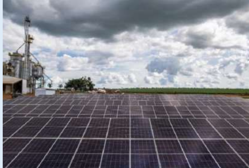
Diretrizes padronizam segurança contra incêndio e pânico para instalações em telhados, lajes e áreas de risco no Mato Grosso do Sul
