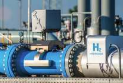
Gasoduto de hidrogênio: o H2 pertence ao grupo IIC, o mais severo.
